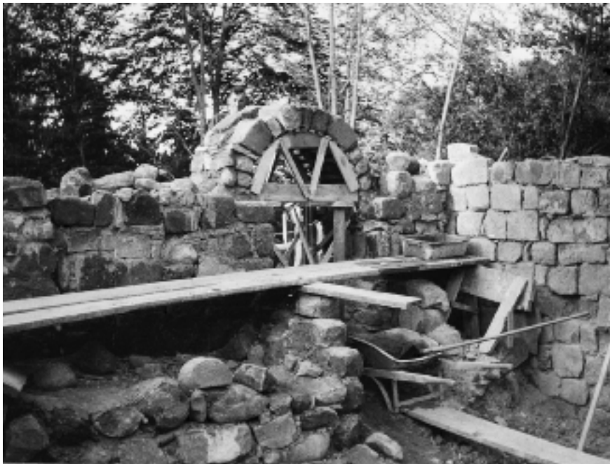
Burgruine Hünenberg: Arbeitsaufnahme bei der Rekonstruktion des Portalbogens, vermutlich 1945/46. Legende auf der Rückseite des Fotoabzuges: «Hinterer Ausgang des Pferdestalles» (Nachlass Emil Villiger).
